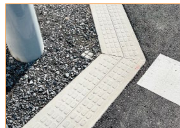
蓋なし製品が必要となり 調整コンクリートの投入が困難
